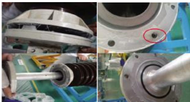
图 10 导电杆法兰与套管法兰对接面 图 11 法兰对接面栓孔处有放电痕迹
